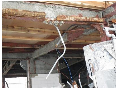
建物に残存した吹付け材
